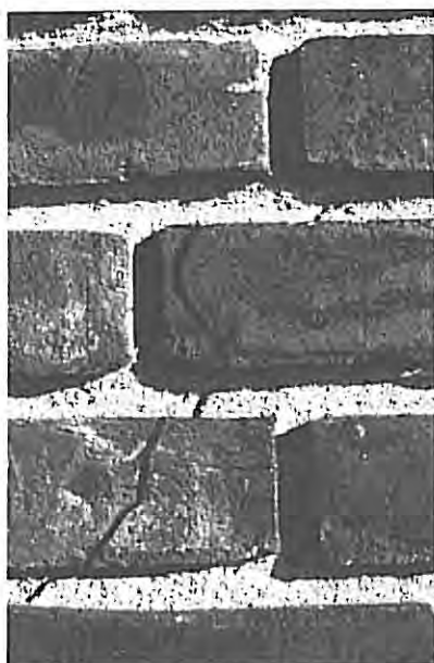
Figur 7.3.4 Sprekker som opptrer uavhengig av stein og fuger
