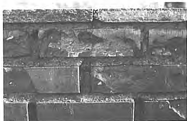
Fig. 7.3.2 Eksempel på frostskader på tegl
