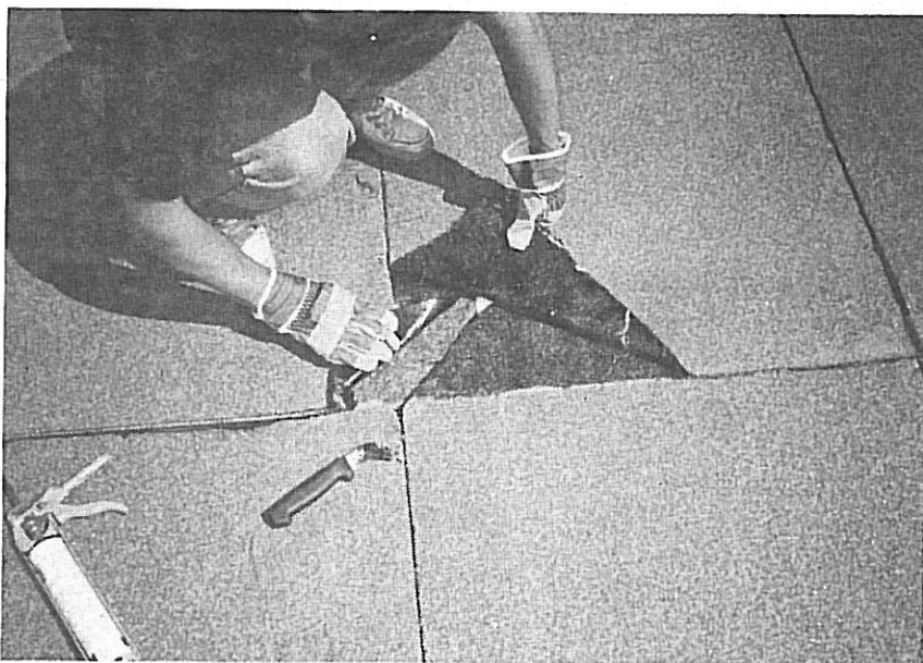
Foto 7 Dårlig klebing av endeskjøter p.g.a. strø.
