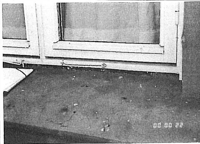
8.1 Synlig polyuretanskum. Mangler sålbenkbeslag. Åpent for vanninntrengning. Saltutslag og pusskader under vinduet bekrefter det.
