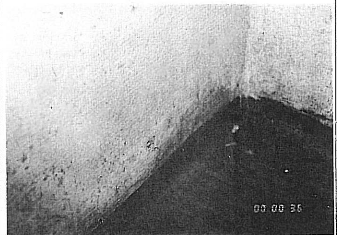
12.6 Malt glassfiberstrie. Dårlig vedlikehold. Vanskelig overgang til gulvbelegg.
