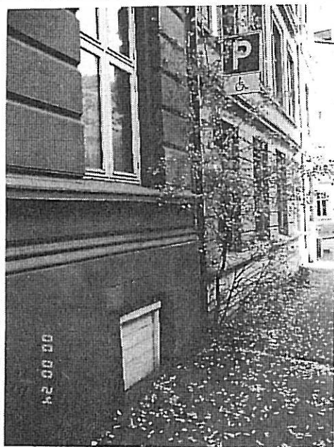
6.3 Løyt kjellervindu med lemmer. Ikke utspyer på nedløp. Busker i overgang vegg/terreng.
