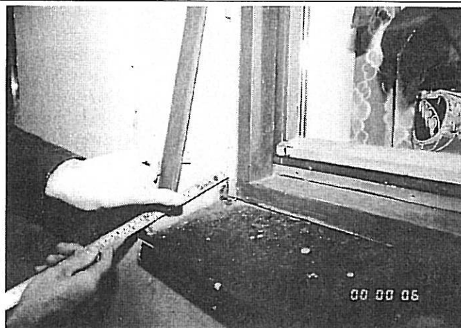
7.5 Ingen isolasjon bak dekkliste.
