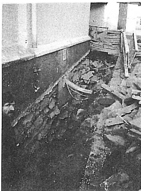
5.5 Utett grunnmur. Lekkasjer til kjeller. Utsprengt byggegruve fører til at vannet står mot muren.
