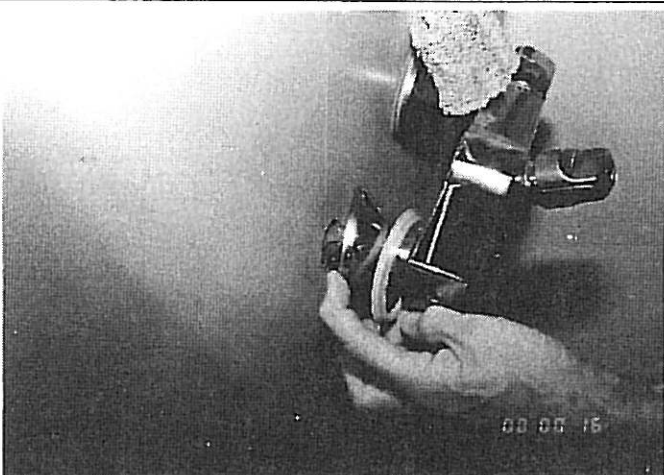
13.3 Utett rørgjennomføring bak armatur i dusj.
