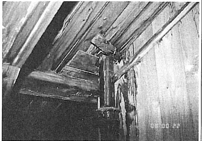
3.4 Gammel lufting av soil står igjen. Kuttet rett under taktro. Fuktig luft føres opp fra etasjene under.
