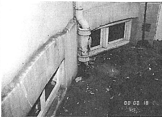
6.1 Lave kjellervinduer. Ødelagt nedløp.
