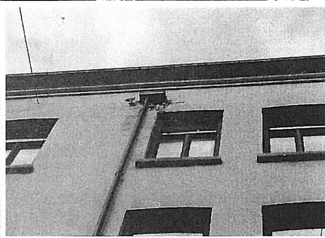
6.6 Utløp fra takterrasse. Skader i puss tyder på lekkasje over lengre tid.
