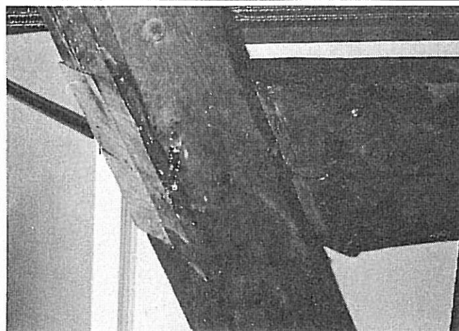
4.5 Loft. Avkuttet knebukk i takkonstruksjon.
