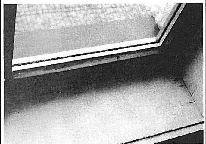
8.4 Fuktskadet nytt vindu. Mangler ventil for inntak av luft til rommet og ovn under vinduet.
