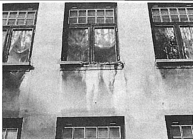
7.2 Skadet sålbenk. Tilsmussing.
