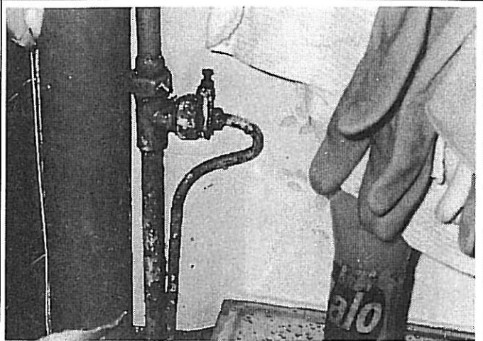
3.2 Gammelt røropplegg på kjøkken.
