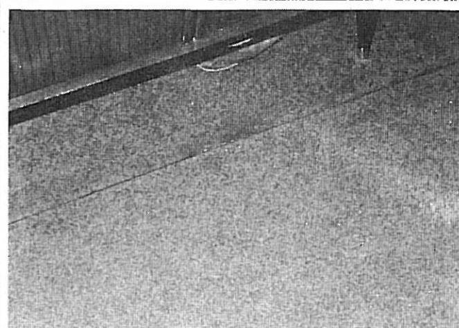
13.6 Tørt rom. Gulvbelegg sprekker opp i skjøt.
