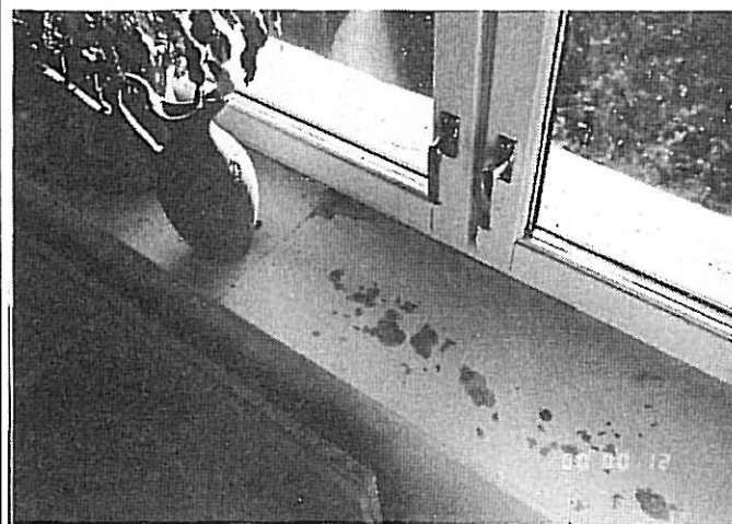
8.3 Fuktskadet vindusbrett innenfor innpusset karm.
