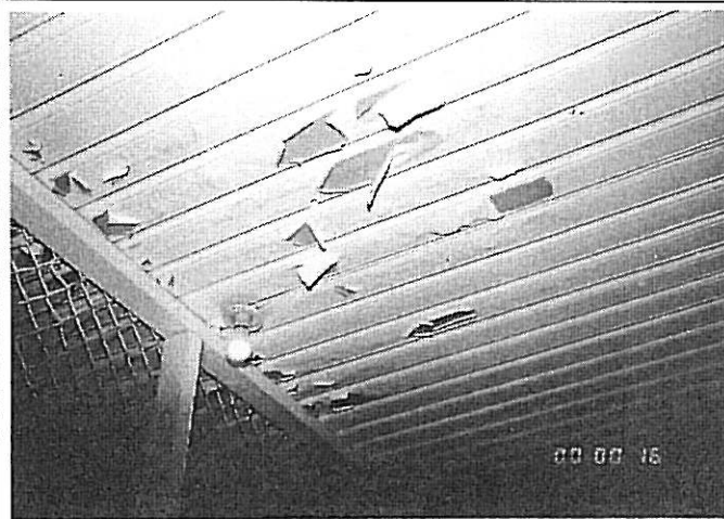
2.3 Brannhemmende maling flasser i kjellerhimling. Nettingboder.
