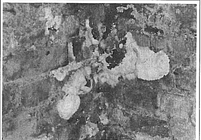
5.4 Hussopp i kjelleryttervegg.
