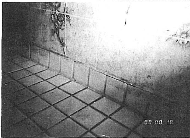
13.1 Dårlig overgang baderomstapet - fliser. Lekkasje.
