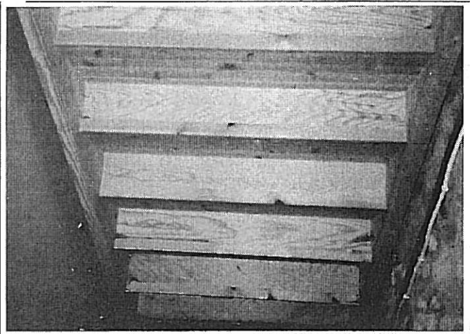
2.2 Underside nytt trappeløp mellom kjeller og trapperom (brannskille). Ubehandlet treverk.
