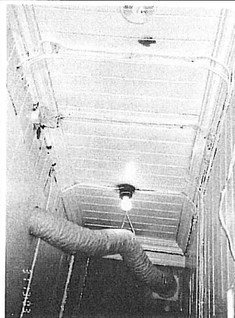
2.5 Ikke brannsikret himling. Ventilasjon fra kjøkken føres ut gjennom yttervegg. Uryddig EL. opplegg.
