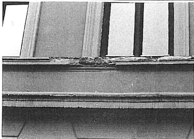
7.1 Skadet sålbenk. Løse deler.
