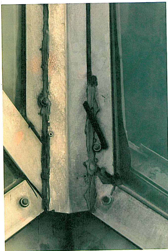
Fig. 12 Dårlig løst sammenskjæring. Stadig vedlikehold er nødvendig
