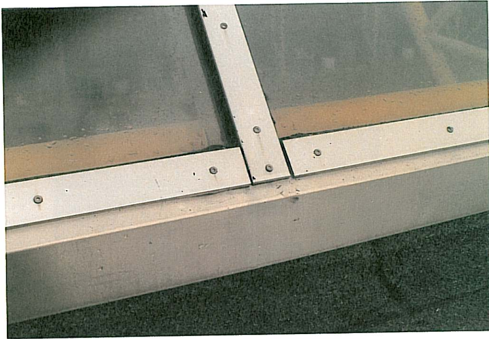
Fig. 21 Dreansjeåpninger ikke påsatt med lekkasje i gesims til følge
