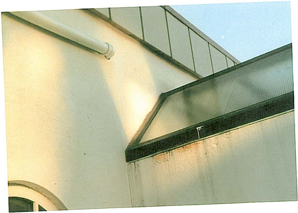
Fig. 17 Uløste detaljer i overgang tak/vegg
