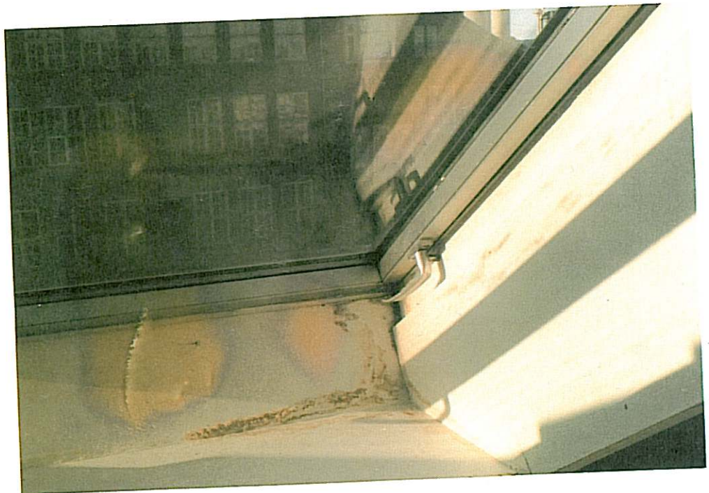
Fig. 18 Lekkasje i takluke/vindu
