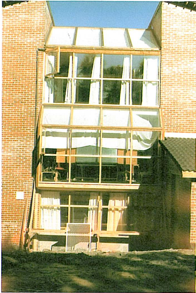
Fig. 13 Alle overganger mellom tak og vegg lekker
