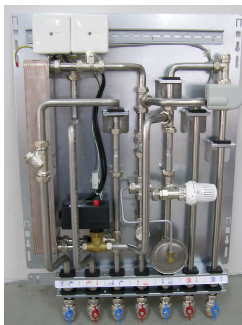
Figur 10.5 Prefabrikkert fordelingsentral (dog ikke isolerte rør) klar til montasje i skap Kilde: /www.thermotechnik.hr
