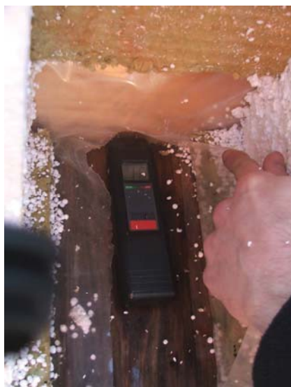
Fig 3.1 Overflaten av massivtreelement angrepet av biologisk vekst ( se svart parti i nedre del av bildet) på grunn av ugunstige fukttekniske forhold i taket . Bilde viser ellers dampsperrsjiktet og isolasjonssjiktet. Foto: SINTEF Byggforsk
