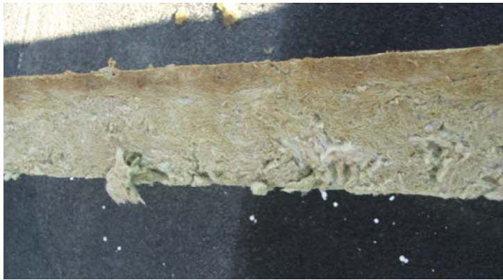
Fig 3.2 Eksempel på fuktansamling i ytre del av isolasjonssjiktet i et kompakt tak basert på massivtreelementer. Foto: SINTEF Byggforsk
