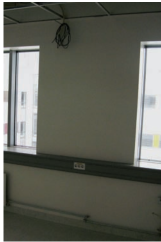
Figur 14. Bildet viser innvendig overflate for en yttervegg der det er benyttet tynnplateprofiler som ikke er slisset.
