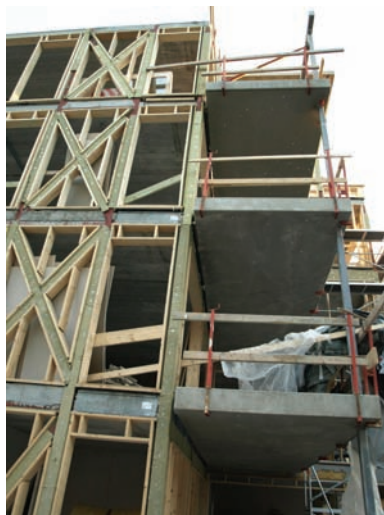
Figur 8. Bilde av overgang mellom vegg og balkong. Her er det stålprofiler som går fra etasjeskilleren og inn i balkongplata.
