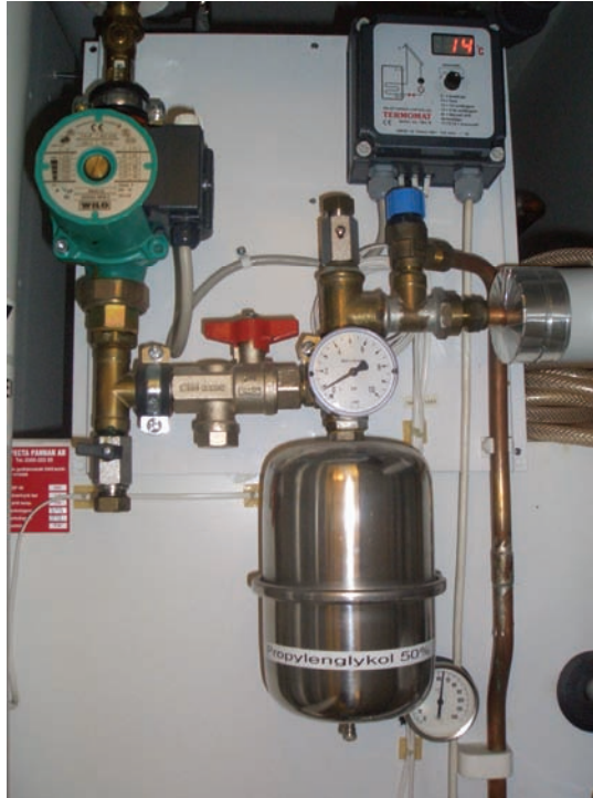
Figur 20. Varmtvannstank med tilhørende styringsautomatikk, måleutstyr og ekspansjonstank plassert i et skap på badet. Foto: Inger Andresen.
