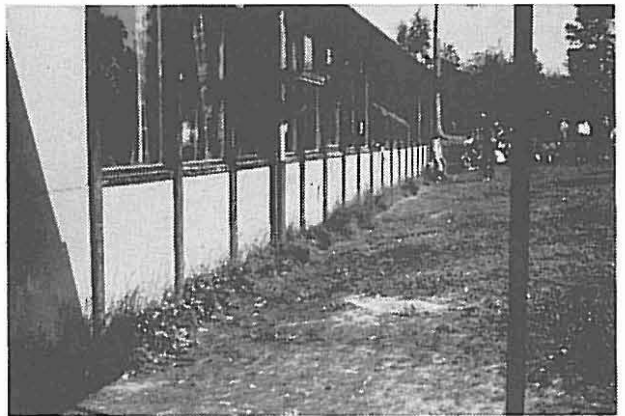
Ventiler godt gjemt av gress, med sterkt redusert ventilasjons-effekt
