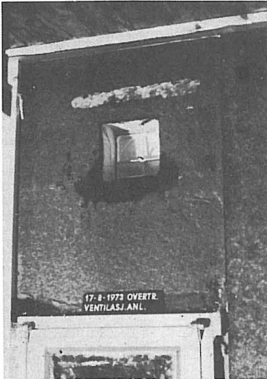
Fig. 3. Nedfuktet trefiberplate under ventil som har vært holdt lukket under hele kjøringen. Fuktprøve P4 Også over vinduer er platen våt. Rim på platen over ventil. Felt 6.
