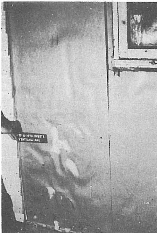
Fig. 11. Rim på forhudningspapp på undersiden av det sted hvor plastfolien var perforert med 10 mm hull, i felt nr 5.
