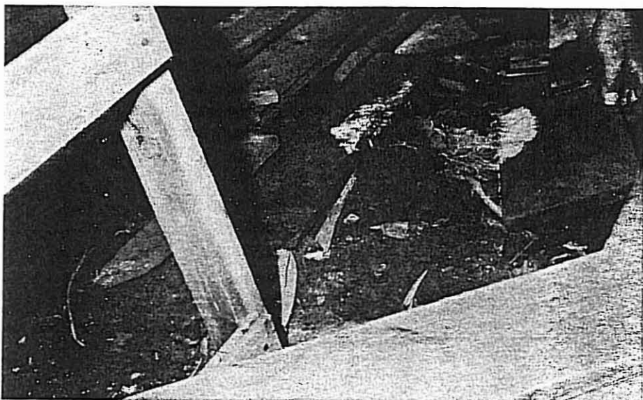
Foto 19. Råte på materialrask i kryperommet.
