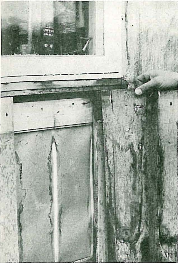
Fig. 17. Vann på baksida av bord og på bakvegg på bolighus i Trondheim. Vertikale, åpne fuger.
