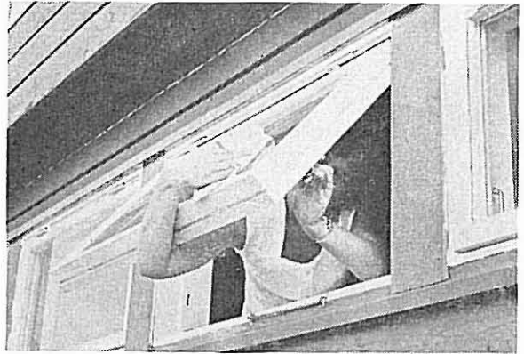
Det er meget vanskelig å pusse ytre side av topphengslete utadslående rammer fra innsiden. Slike vinduer gir også dårlig nyttbar åpning for puss av nabovinduer.
