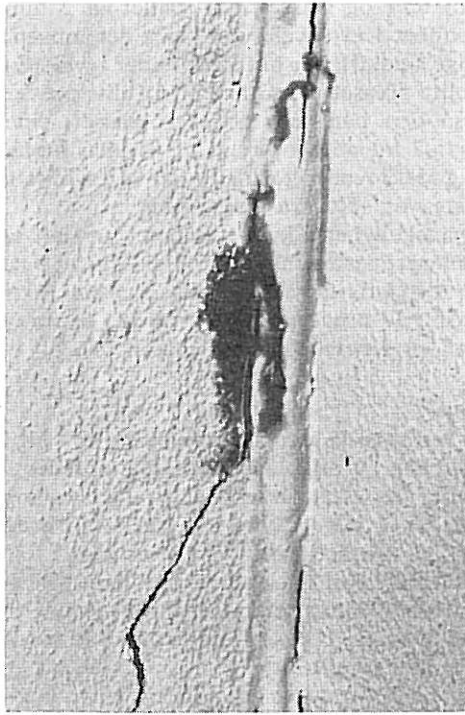
Fig. 11. Oljeblødninger ved en ekspansjonsfuge.
