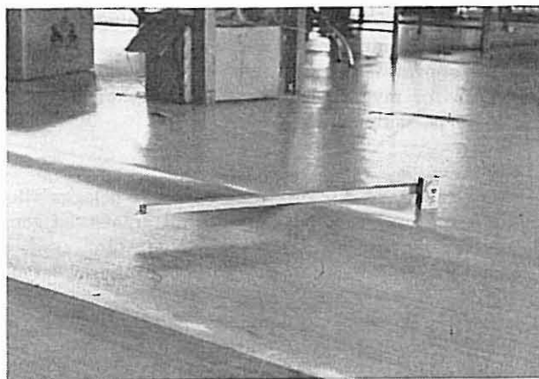
Fig. 1. Linoleumbelegg ødelagt av fuktighet.
