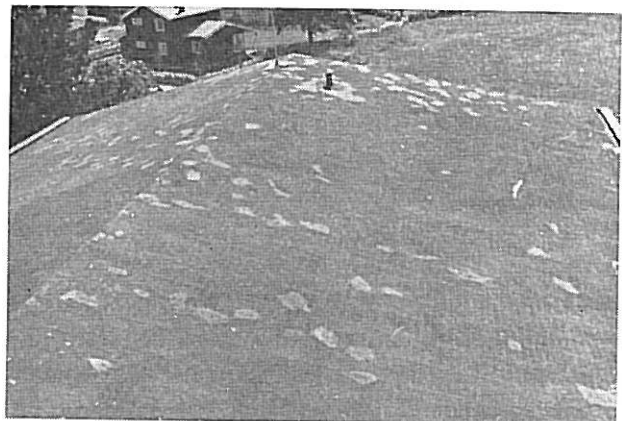
Fig. 2. Tynne tekninger skades lett selv på bordtak. Bordene vises gjennom tekningen.
