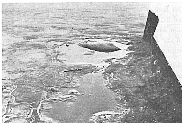
Fig. 8. Ødelagt tekning på massivt, uluftet tak.
