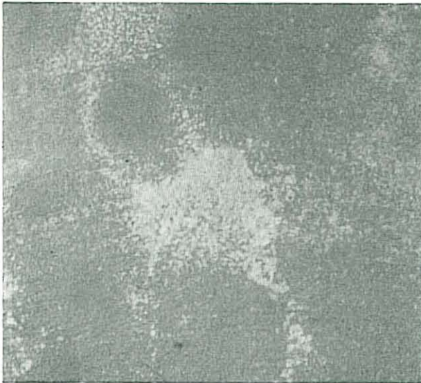
Fig. 27. Saltutslag på utvendig puss.
