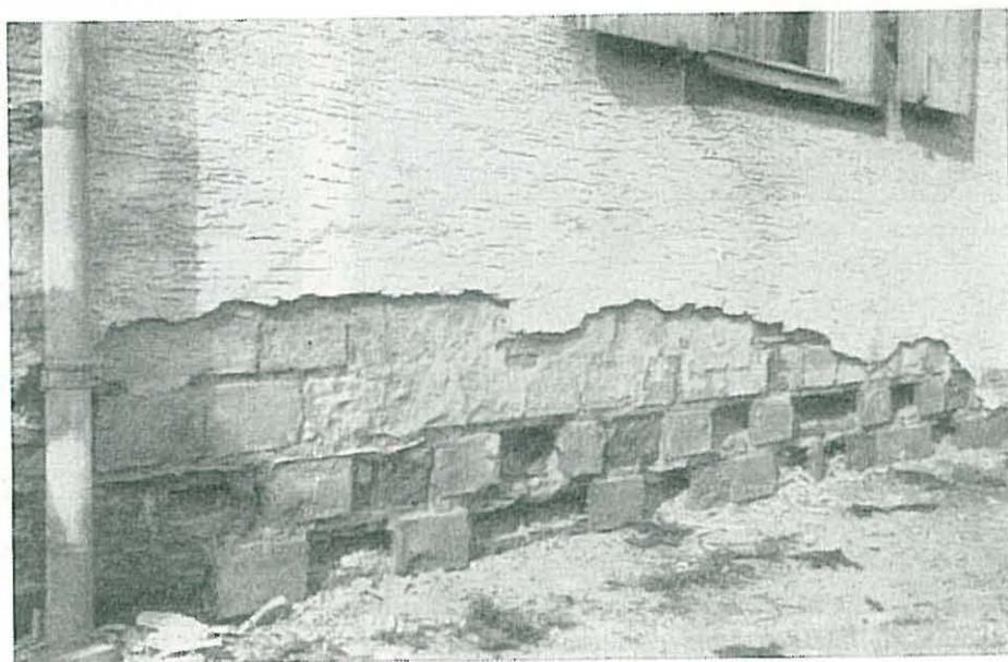
Fig. 25. Pussen er falt av fordi underlagsmaterialet har fått store frostskafer.
