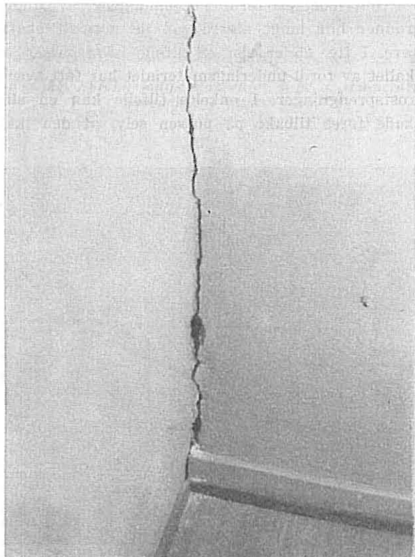
Fig. 19. Sprekk over dilatasjonsfuge.
