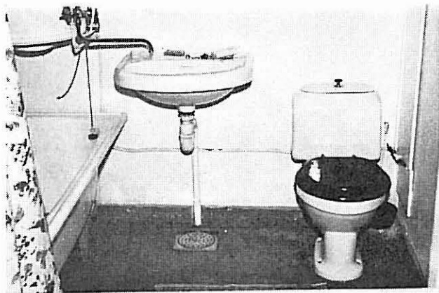
Fig. 6. Interior av baderom i Kristiansands gate 17. Plast vann- og avlopsledninger er ført opp i sliss til høyre. 12 mm utvendig målt polyetylenrør er lagt fra kjellerene fram til hver leilighet. Vanntilførselen er 15 l/min, 15 % mer enn vanlig for denne type bad. Røret klemmes til veggen som en elektrisk ledning. Vannlåsen og avløpet fra servanten er også i plast.
