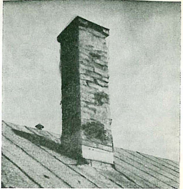
Fig. 9. Skorsten på villa ved Oslo, som ble ødelagt etter 2 sesongers fyring med parafinbrenner. Etter den første sesongen falt pussen (rapping) av. Etter den andre sesongen var fugene ødelagt, og deler av teglstenen falt ned. Som en sikkerhet hadde eieren trukket netting rundt skorstenen. Etter byggeforskriftene skal skorstenen over tak mures med hårdbrant sten, men det viste seg at denne bestemmelse ikke var fulgt. Årsaken til dette ble oppgitt å være at hårdbrant sten har vært vanskelig å skaffe i etterkrigsårene. En pipe av hårdbrant sten ville muligens ha holdt stand noe lenger.
