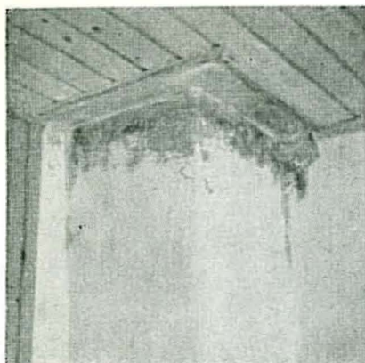
Fig. 10. Kondenssskade i soverum i 2. etasje. Sammen med kondensvannet følger plagsom lukt. 9" x 9" skorstenen med 2 ildsteder. I 1. etasje petroleumbrenner, i 2. etasje kamin for fast brensel, som nyttes bare på kalde dager. Oppvarmingen skjer vanligvis elektrisk.
