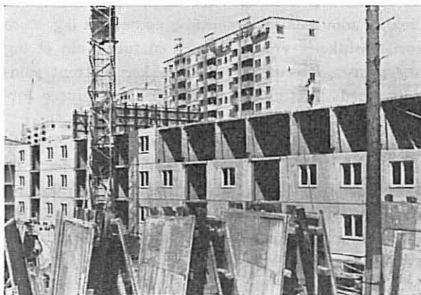
Fig. 7. Fra arbeidet på en av blokkene. I forgrunnen sees oppstilt veggforskaling. I bakgrunnen sees et «skivehusene».
