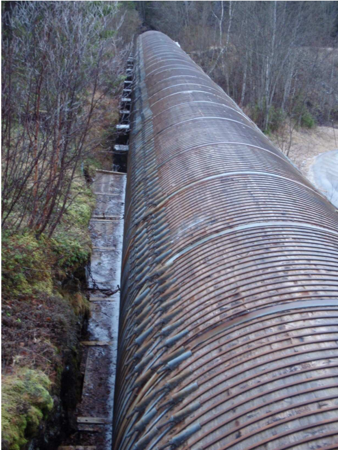
Figur 8. Rørgaten til Reinforsen kraftverk sett oppover. Røret er bygget i treverk med strammebånd.
