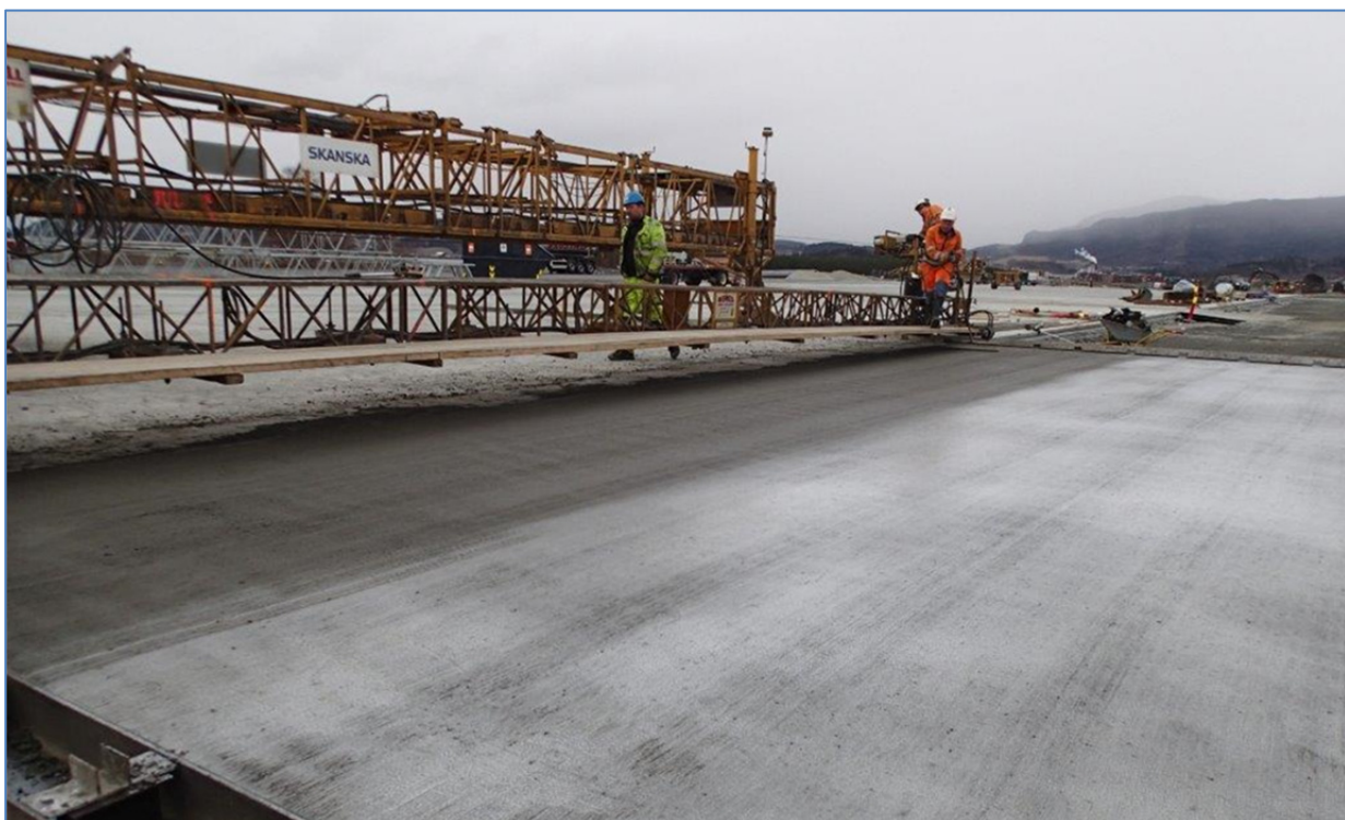
Figur 4. Kosting av ferdig støpt dekke, og beskyttelse ved påsprøyting av herdemembran. (Foto: Gunrid Kjellmark, SINTEF Byggforsk)
