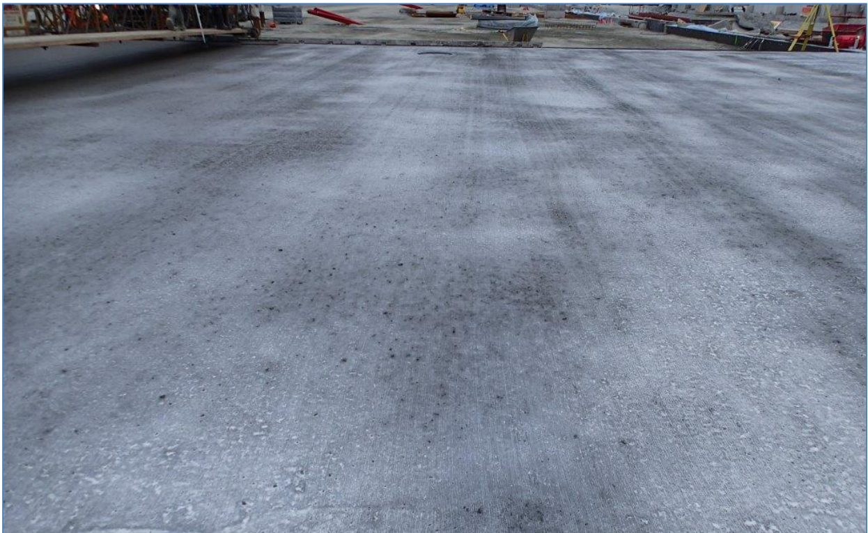
Figur 5. Struktur i betongoverflaten. (Foto: Gunrid Kjellmark, SINTEF Byggforsk)
