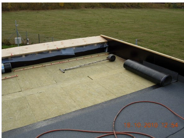
Fig 2.9 Umiddelbart etter at isolasjonen var ferdig lagt og tilført planlagt fuktmengde ble taket tekket med ettlags asfalt takbelegg.
