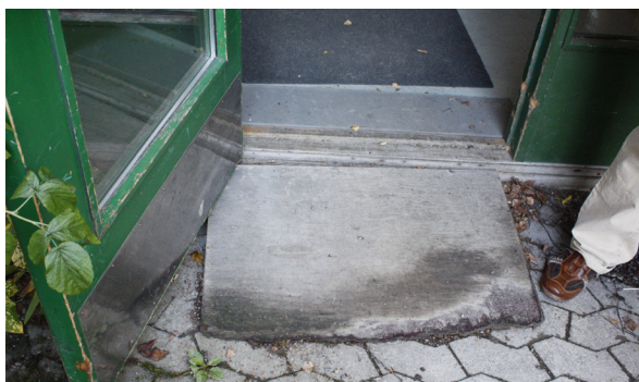
Opprinnelig dør med skråbrett som er montert i ettertid. Denne løsningen har vært brukt flere steder, men det har forekommet at brettet er fjernet.
