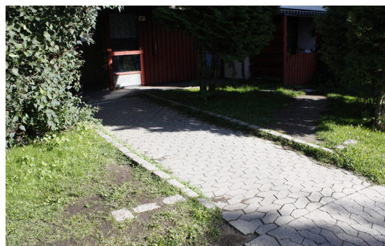
Over: Inngangsparti med kantstein, viktig ledelinje for personer med synsnedsettelse. Slitte og ujevne overflater.
