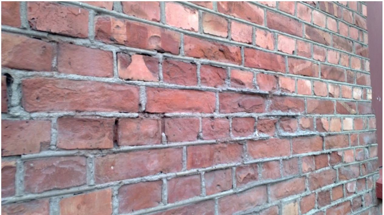
Figur 2.4 Frostskader i eldre teglsteinsfasade. Kilde: Byggforskserien
