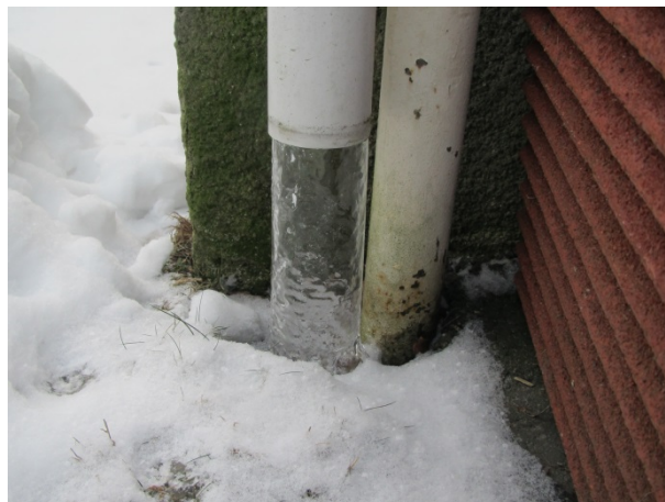
Foto 4 (SINTEF Byggforsk) Detalj fra frikoblet taknedløp viser vannet som fryser vinterstid.
