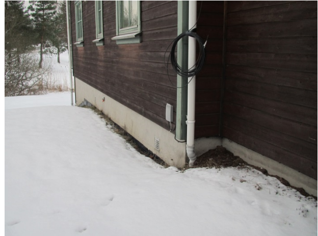
Foto 17 (SINTEF Byggforsk) Taknedløp går ned i terreng. Ikke noe fall fra terreng bort fra bygningen.
