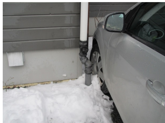
Foto 28 (SINTEF Byggforsk) Nedløp tilkoblet kommunalt overvannssystem
