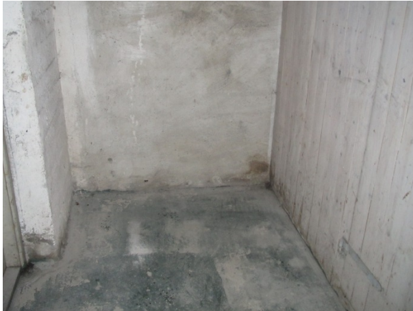
Foto 6 (SINTEF Byggforsk) Typisk rom i kjeller. Treveggen til høyre har merker etter oppfukning i underkant. Ellers ikke noen alvorlige skader.
