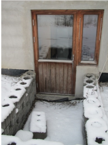
Foto 16 (SINTEF Byggforsk) Utsatt kjellerinnngang uten beskyttende takoverbygg. Stor risiko for vannansamling utenfor og inntrenging av vann ved sterk nedbør eller snøsmelting
