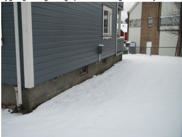
Foto 3 (SINTEF Byggforsk) Tilsvarende situasjon som på foto 1 og 2. Lite fall på terreng fra bygningen. Ingen tegn på fornyet drenering. Takvannet slippes ned direkte på terreng ved sokkel.
