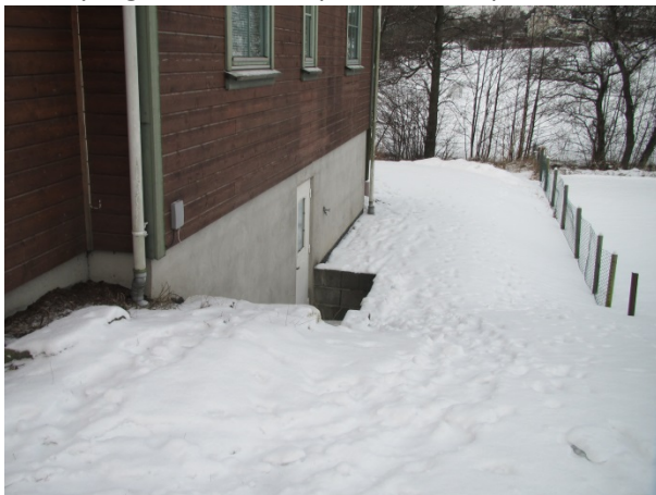
Foto 14 (SINTEF Byggforsk) Dårlig fall på terreng fra huset. Kjellerinngangen er plassert med fare for at overflatevann kan finne veien inn ved store nedbørmengder eller smeltevann. Vi ser også at taknedløpene er ført ned under terreng i rør.
