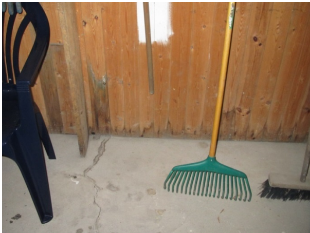
Foto 8 (SINTEF Byggforsk) De er synlige merker etter oppfukning i nedre del av delevegger av tre. Det kan være en fordel å skille de skadeusatte organiske materialene fra underlaget slik at det er lettere å tørke ut etter en vanninntrengning. Veggene kan eksempelvis monteres på oppklossing av fuktbestandig materiale. Alternativt unngå å bruke treverk.
