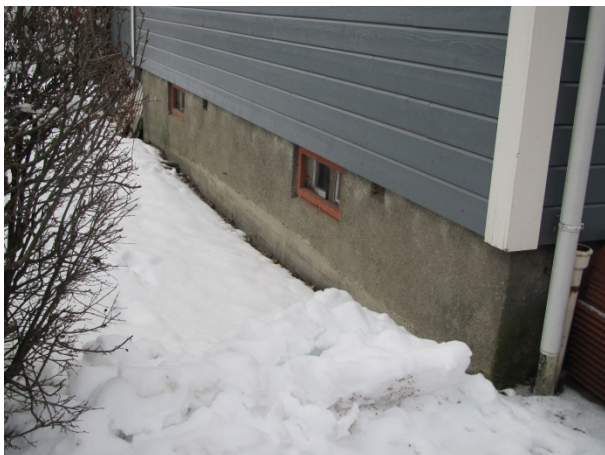
Foto 1 (SINTEF Byggforsk) Dårlig fall på terreng fra huset. Vi ser også at nedløpsrøret fra tak er koblet bort fra røret som går under terreng. Takvannet slippes rett ned på bakken ved sokkelen. Vannet burde ha vært ledet bort fra bygningen. Ingen tegn på at dreneringen er fornyet.
