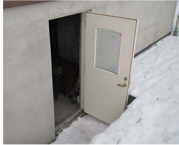
Foto 19 (SINTEF Byggforsk) Kjellernedgangen er utsatt for vanninntrenging hvis den ikke holdes fri for snø og is om vinteren. Det er dårlig fall på terrenget rundt bygningen.
