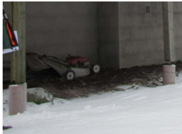
Foto 15 (SINTEF Byggforsk) På nedsiden av bygningen hvor hele kjellerveggen ligger over terreng, er det dårlig fall på terrenget fra bygningskroppen.
