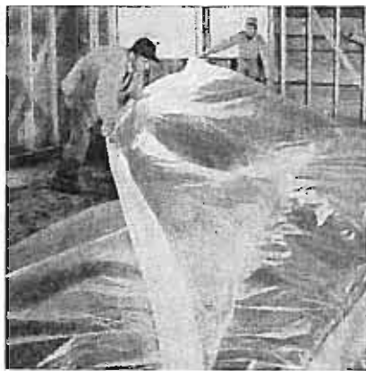
Fig. 5. En plastduk (polyetylen) på 4,80 m legges ut som dampsperrsjikt under betongplaten i et kjellerløst hus.
